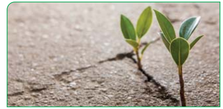
Abb. 8 Pflanze, die unter schwierigen Bedingungen wächst – Risse im Asphalt
